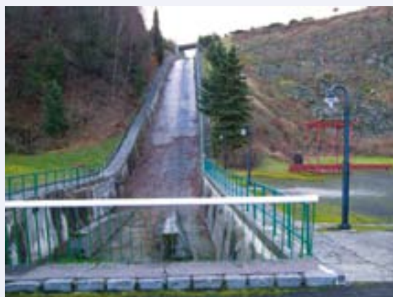
Současný stav skluzu od bezpečnostního přelivu na údolní nádrži Šance. Rekonstrukce skluzu je předmětem akce „VD Šance-převedení extrémních povodní“.
