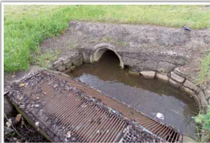
Nekapacitní zatrubnění odvodňovacího příkopu Vlčoku
