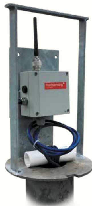
Žhavá novinka – automatický snímač sledující průsak hrází s bezdrátovým (wi-fi) přenosem na přehradě Olešná
