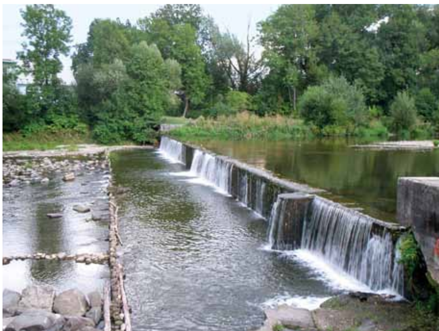
Technický stav stupně je v současné době nevyhovující
