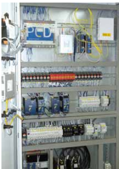
Rozvaděč zásroku RNZ1
