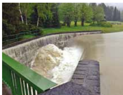
Proudění při průtoku 85 m 3 /s za povodně dne 18. 5. 2010
