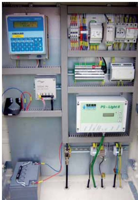
Vybavení vodoměrné stanice v Tiché
