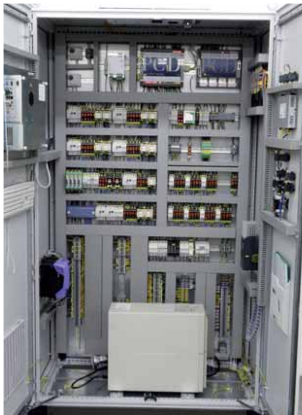
Pohled na vnitřní uspořádání nového datového rozvaděče
