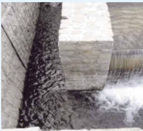
VT Bílá ř. km 21,710 - funkční rybí přechod - dolní vstup rybího přechodu zaústěný ve vývaru foto Lojkásek
